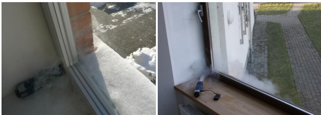
Attēls 2.103 Logu konstrukciju un montāžas vietu hermetizācijas pārbaude ar dūmu ģeneratora palīdzību.
