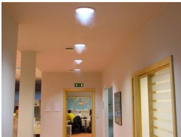
Attēls 2.102. Dūmi no testējamās telpas nonāk blakus telpas griestos un norāda uz to savienojumu.
